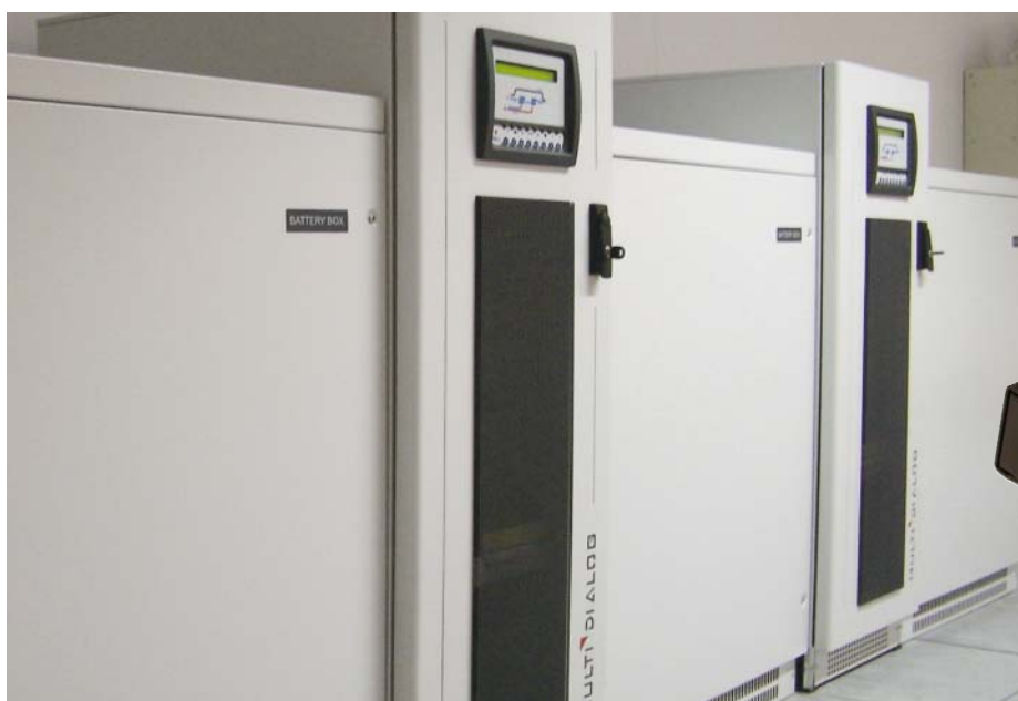
Bild links: Online-Doppelwandler USV-Anlagen bieten eine hohe Sicherheit für kritische Lasten.
